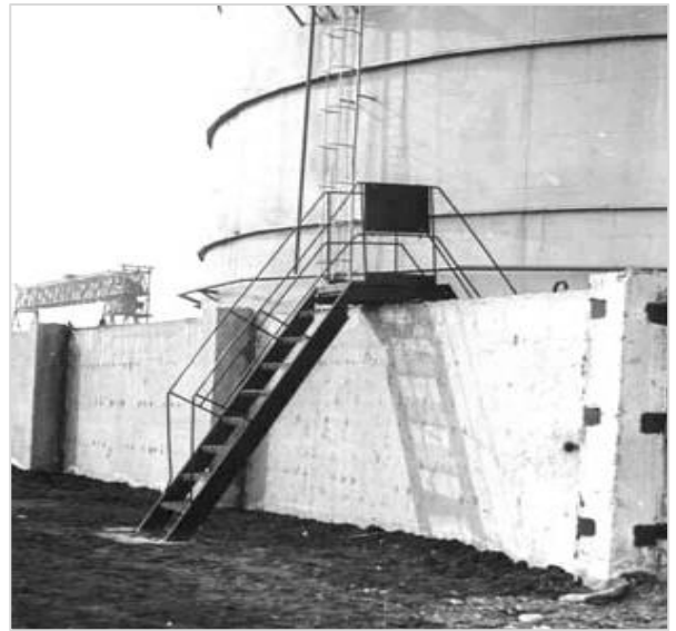
Рисунок 1.15 – Общий вид ограждения до аварии РВС № 2
