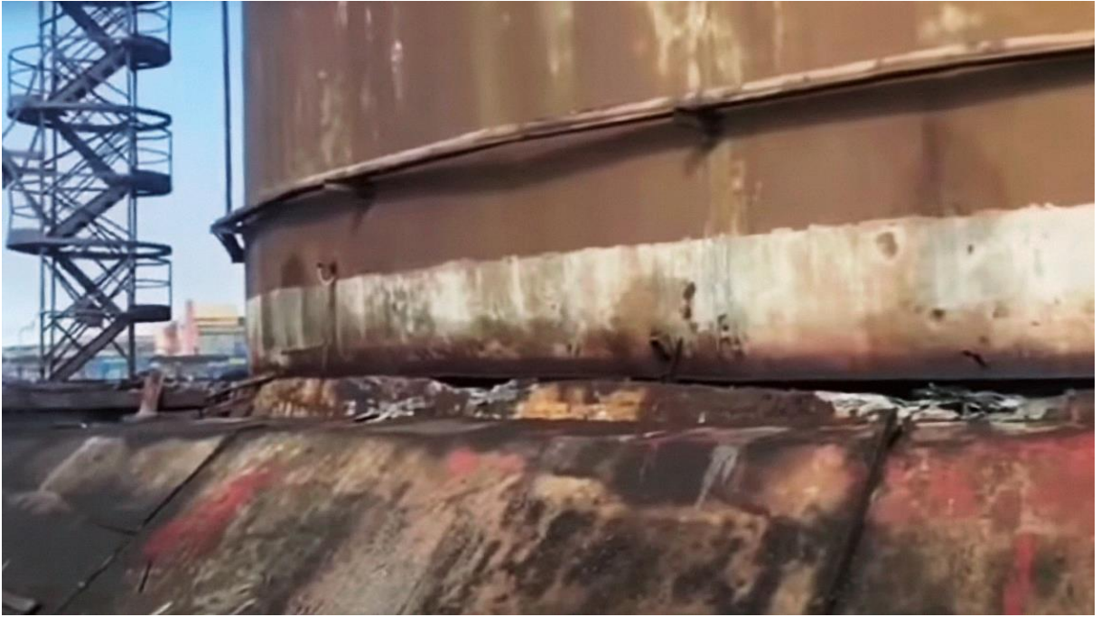
Рисунок 1.23 – Участок разрушения резервуара на ТЭЦ-3 в г. Норильске
