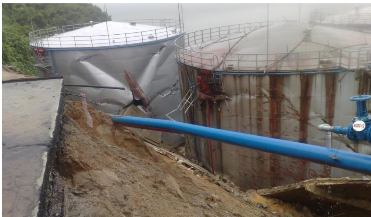
Рисунок 1.28 – Общий вид поврежденных резервуаров на нефтебазе «Льен Чиену»
